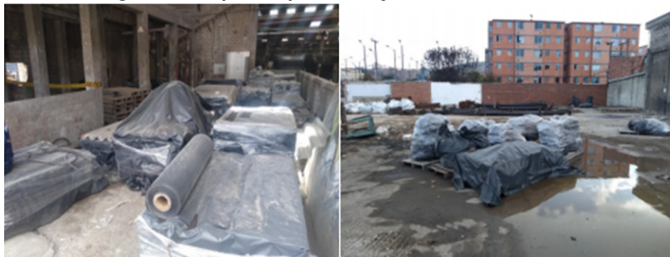
Imagen 11. Acopio temporal de tejas de asbesto-cemento
